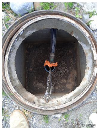
Forage situé dans un regard en béton (vue intérieure)
