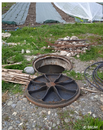
Forage situé dans un regard en béton (vue extérieure)
